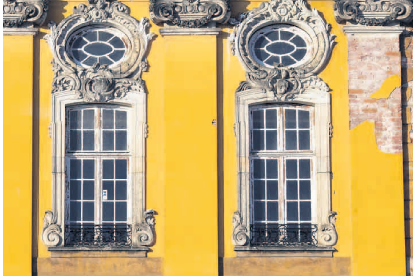
Wenn der Putz abbröckelt: Die Außenfassade des Schlosses Dornburg in Sachsen-Anhalt
